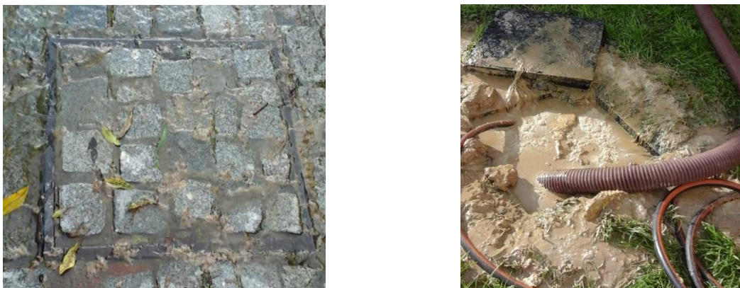
Fig. 4.7 – CRL's em carga após evento pluviométrico (imagens retiradas da plataforma de ocorrências das AdP)
