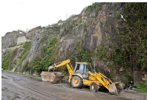
Fig. 2.6 - Deslize de terras proveniente de uma escarpa na avenida Gustavo Eiffel no dia 15 janeiro de 2020 (José Carmo / Global Imagens, 2020)
