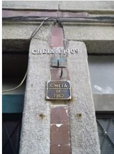
Fig. 2.3 – Marca da altura de água atingida num edifício na zona da ribeira do Porto (Razalas,2015)
