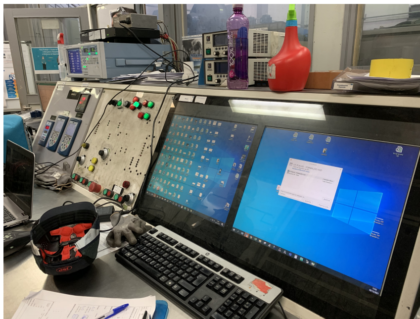
Figura 4.2: Bancada do Laboratório de ensaios WEGeuro
