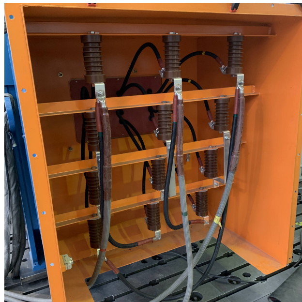
Figura 4.14: Ligação nos terminais do estator - W60 630 L 4
