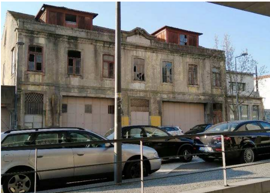
Figura 22 — Fotografia sobre a degradação do edificado na cidade do Porto
