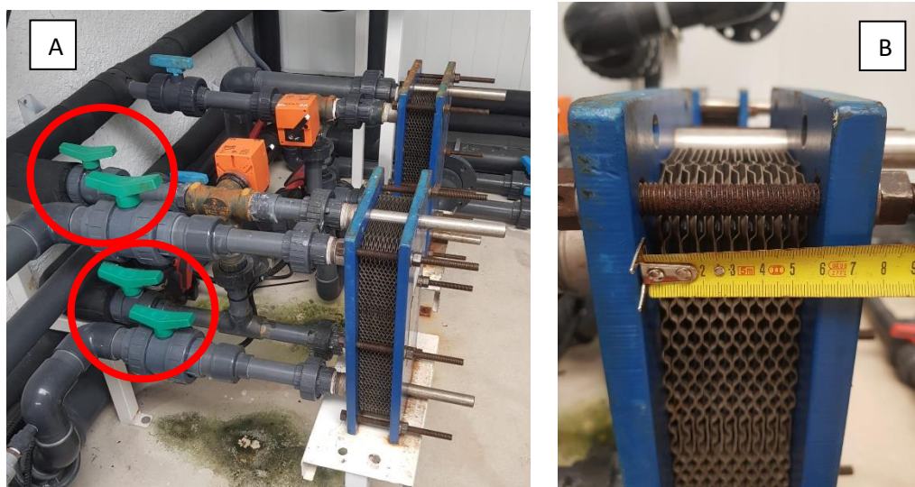
Figura 1 - A -Válvulas de permutador abertas; B - Distância entre as placas azuis;
