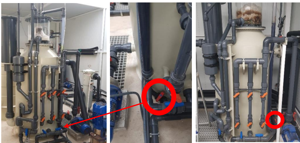
Figura 1 - Skimmers, e respectivas válvulas de esgoto;
