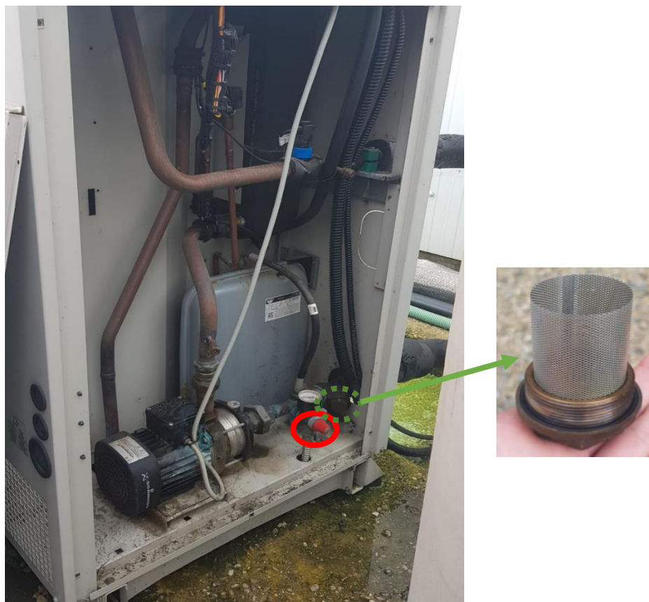
Figura 1 - Bomba de calor na parte externa da empresa
