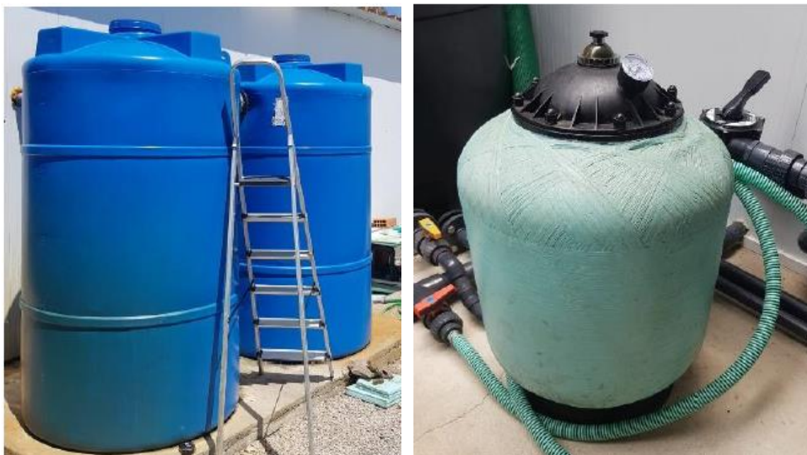
Figura 12 - Reservatórios de água e filtro de areia.
