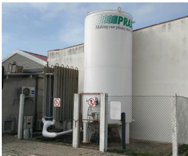
Figura 26: Zona de depósito de oxigénio líquido (fotografia tirada por Tiago Foz)
