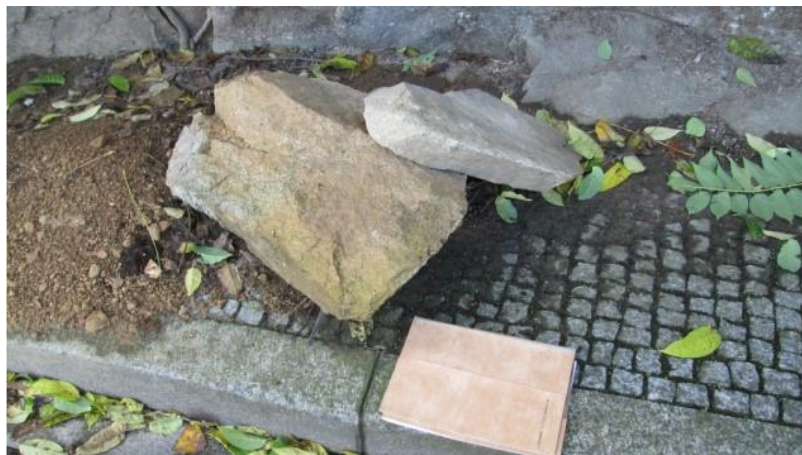
Figura 46 - Várias situações de quedas de blocos observados nos locais A2 e A3 (Veconcept ,2008).
