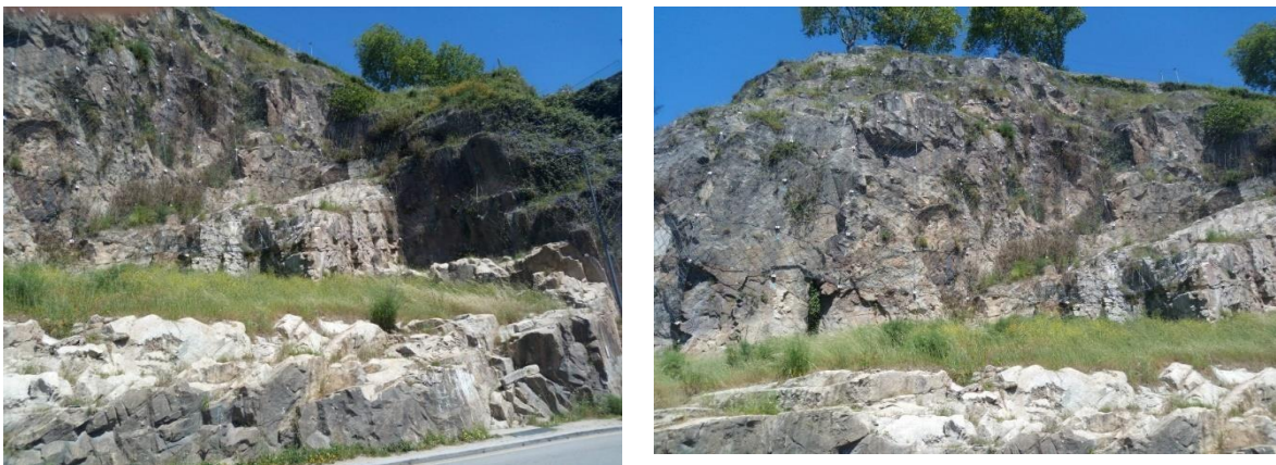
Figura 17 - Local P (Zona B) à esquerda. Pormenor da rede com pregagens à direita.
