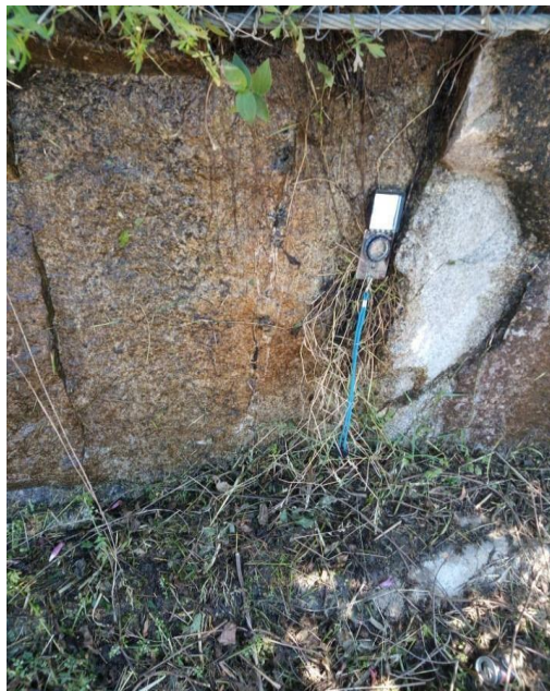
Figura 28 - Local 5. Pormenor da oxidação do granito devido à percolação constante de água.
