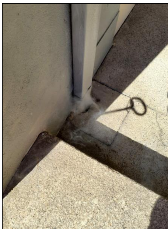
Figura 40: Saída de fumo no tubo de queda vertical de águas pluviais junto ao pavimento.
