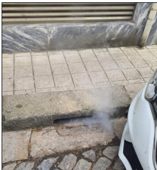
Figura 39: Saída de fumo pela sarjeta.
