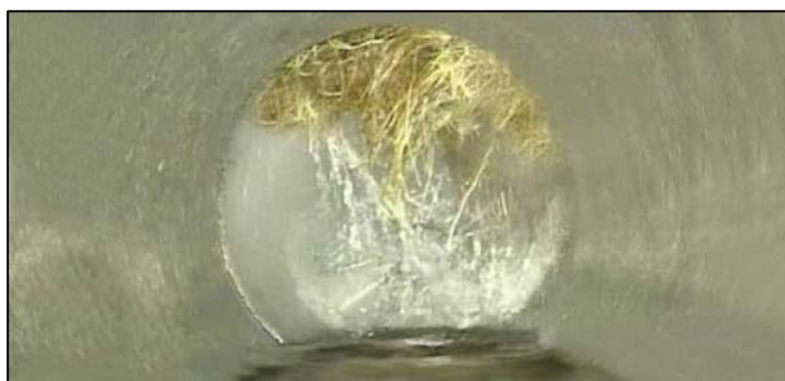
Figura 34: Exemplo de raízes infiltradas no coletor.
