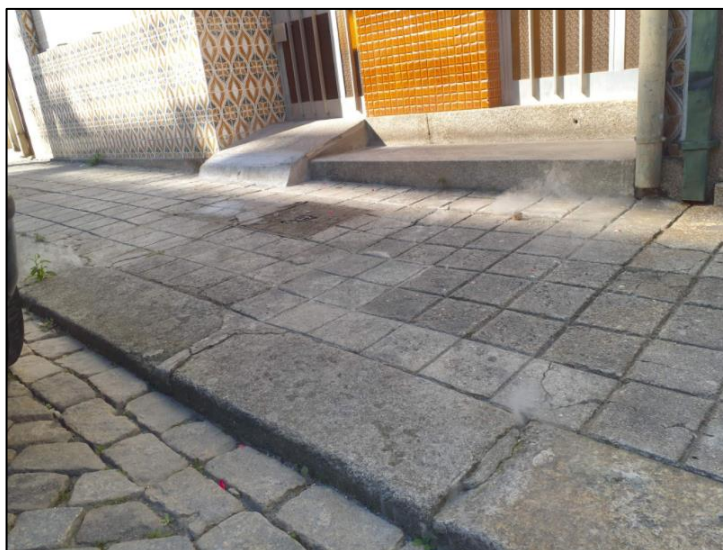
Figura 41: Saída de fumo no pavimento devido à degradação da caixa ramal de ligação e do pavimento envolvente.
