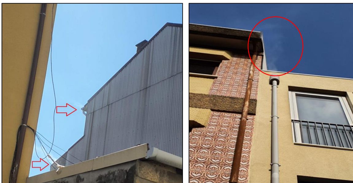
Figura 38: Saída de fumo nas caleiras dos edifícios.
