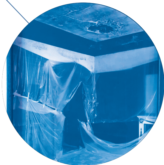
Fig. 19 Sala de Jantar em abandono 2016
