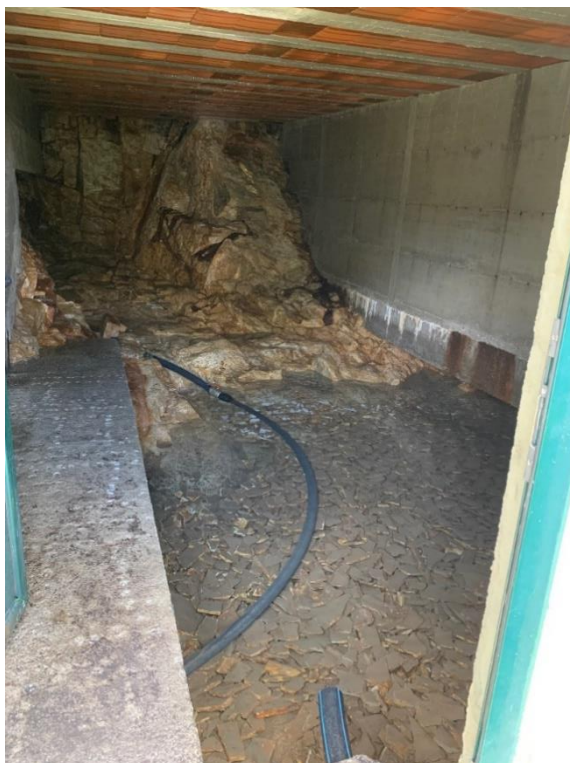
Figura 14 – Captação de água.
