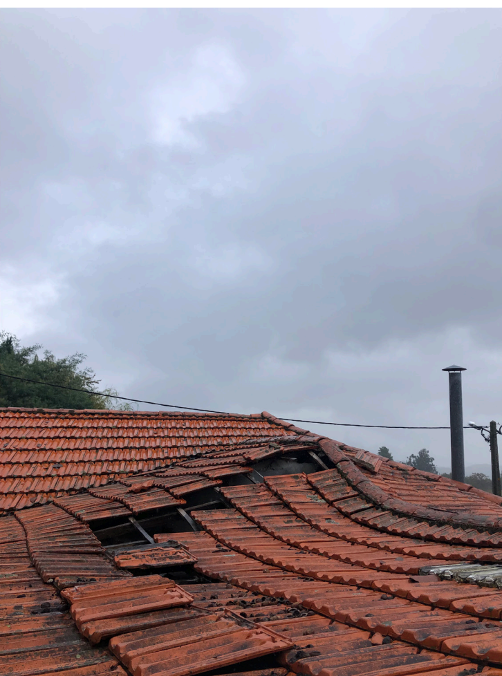
Figura 82. A construção apresenta alguns pontos débeis, nomeadamente em elementos primordiais da sua constituição, como a cobertura. O facto da parede intermédia que sustentava o telhado ter ruído em parte, originou esta patologia identificável na imagem. Com esta abertura, entra naturalmente água, e amplia os níveis de insalubridade.
