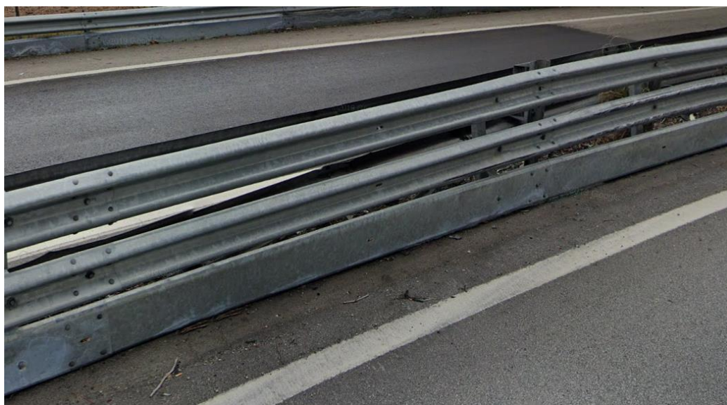
Figura 5.24- Guardas de Segurança metálicas flexíveis (Fonte: Google Maps)
