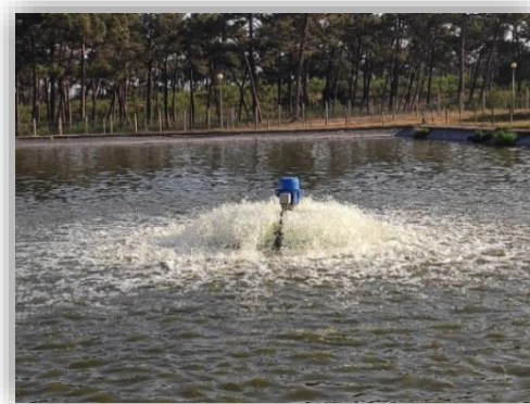
Figura 39 – Arejador em funcionamento na ETAR em S. Jacinto.
