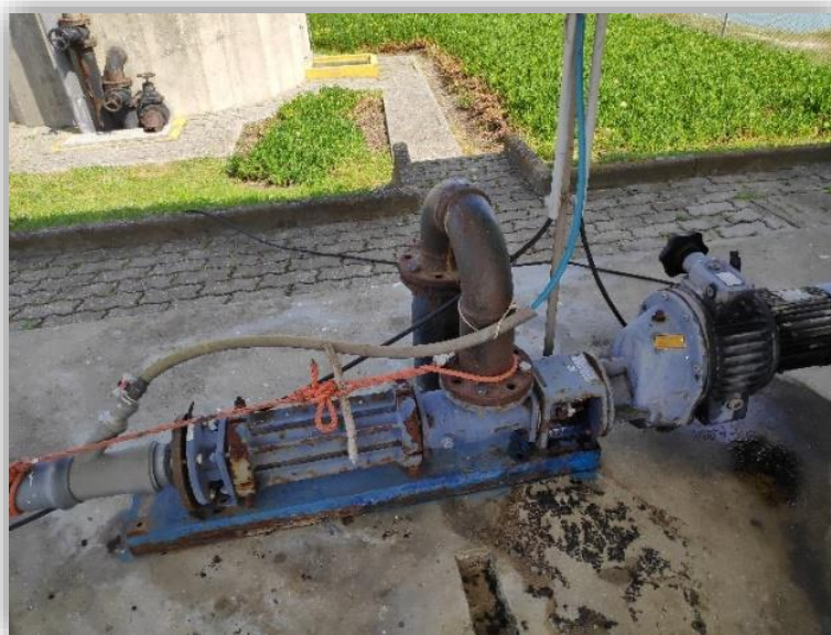
Figura 44 – Instalação da ETAR com bomba de lamas e entrada de polímero floculante pelo tubo azul.
