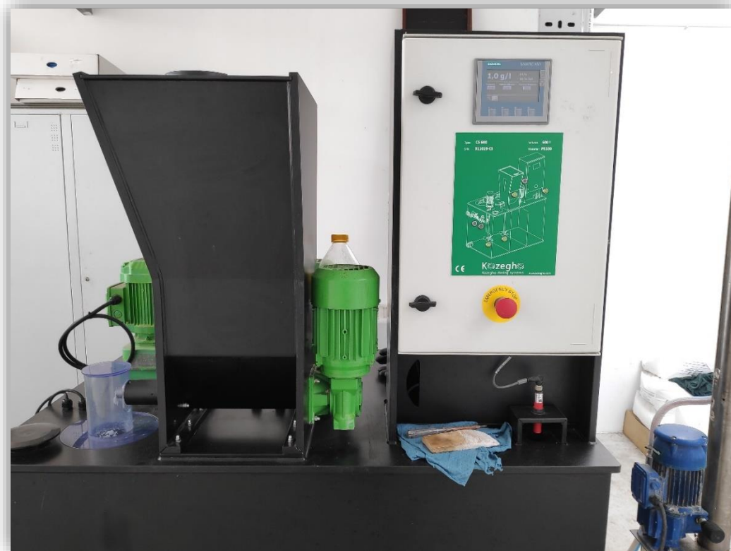
Figura 43 – Equipamento utilizado para preparação e dosagem de floculante da ETAR na Figueira da Foz.
