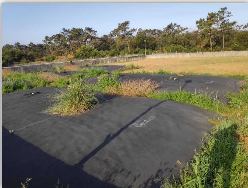
Figura 41 – Unidades Geotube® instaladas na ETAR em S. Jacinto com lama consolidada no seu interior.
