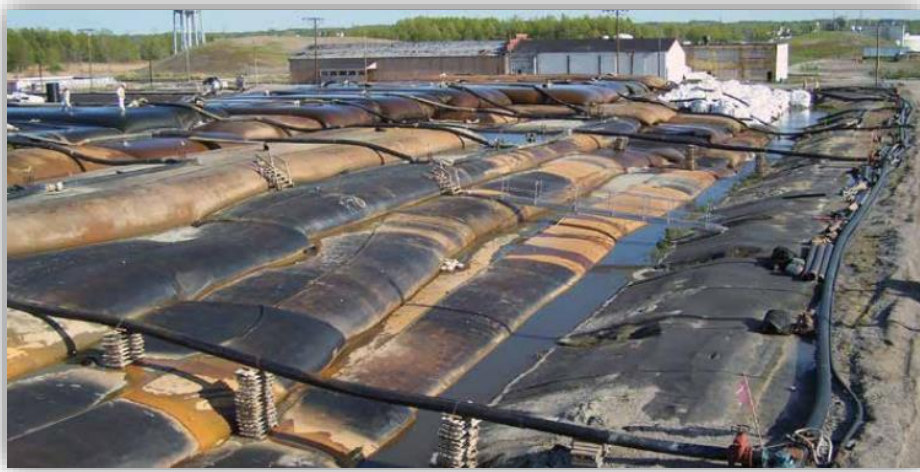
Figura 37 – Aplicação da tecnologia Tencate Geotube® na remediação de um rio nos Estados Unidos da América (Tencate Geotube® Case Studies, 2021).
