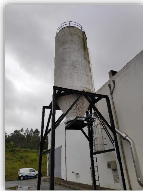
Figura 21 – Silo para armazenamento de lamas desidratadas por centrifugação em ETAR.
