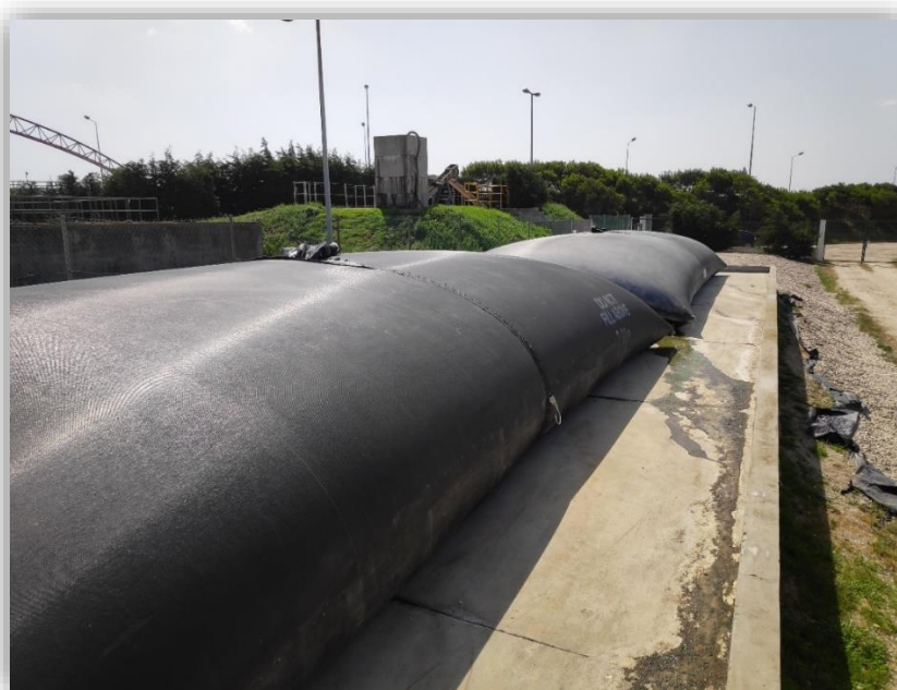
Figura 46 – Unidade Geotube® em funcionamento da ETAR na Figueira da Foz sobre uma plataforma construída para a estrutura.
