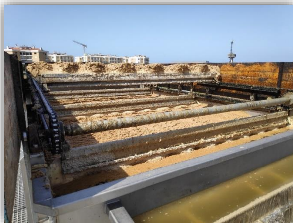
Figura 7 – Flotador de gorduras com ponte raspadora numa ETAR.
