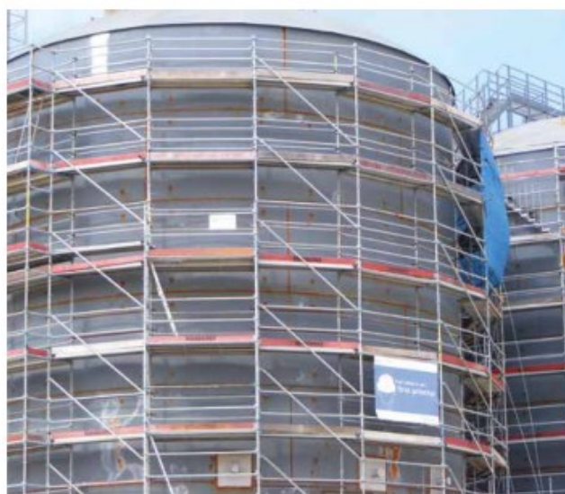
Figura 3.5 - Exemplo andaime multidirecional, METALUSA [56]
