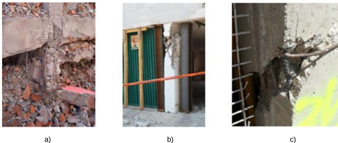
Fig. 5 - Danos associados a amarrações inadequadas e/ou devido ao uso de armaduras lisas, bem como erros na dobragem de estribos, observados no após-sismo de a) Gorkha, Nepal, 2015; b) México, 2017; c) L'Aquila, Itália, 2009 (adaptado de Varum et al. 2017, Furtado 2020, Vicente et al. 2012)
