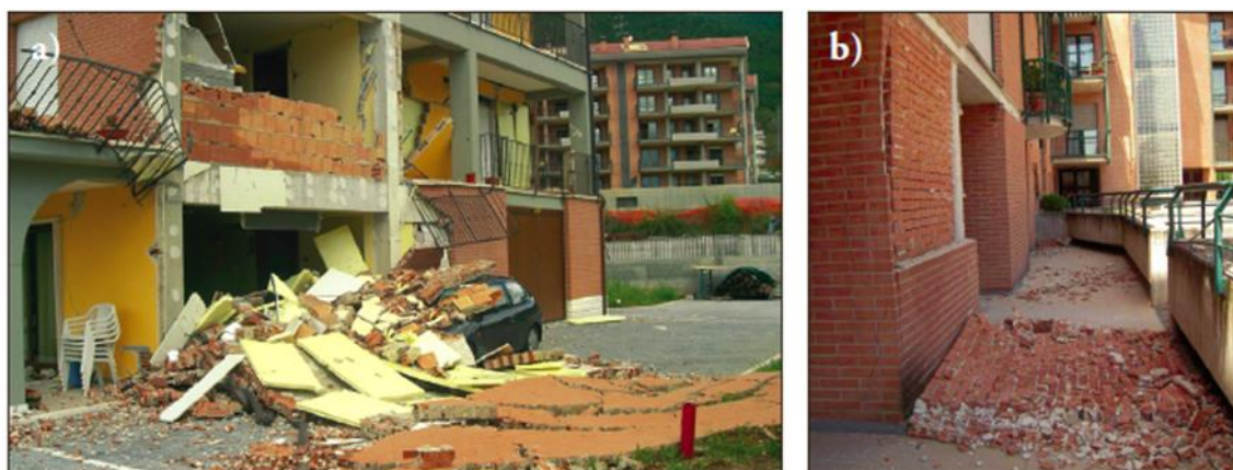
Fig. 18 - Colapso de paredes de alvenaria para fora do plano: a) Painel completo; b) Pano exterior de um painel (adaptado de Furtado 2020)
