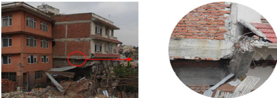
Fig. 12 - Danos observados no após-sismo de Gorkha, Nepal, 2015 (adaptado de Varum et al. 2017)
