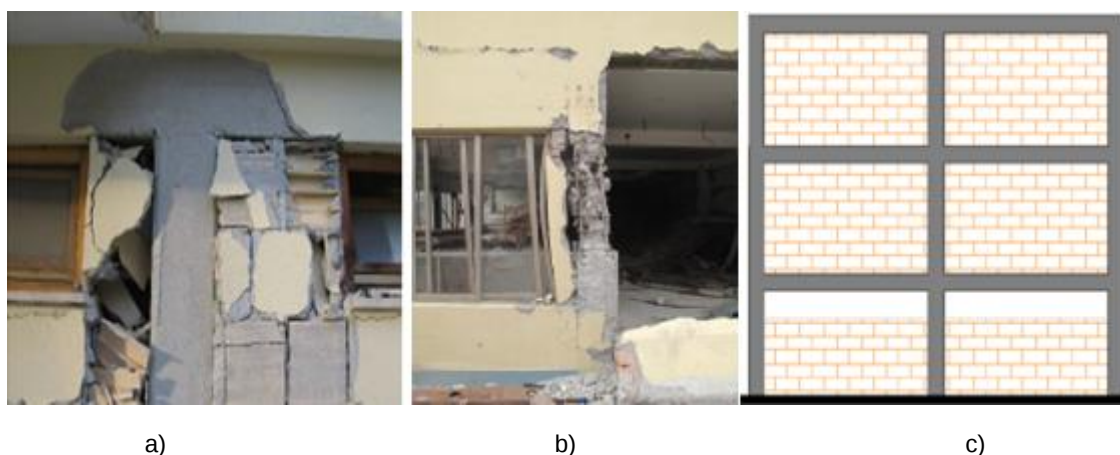
Fig. 9 - Danos associados a mecanismo de pilar curto, observados no após-sismo: a) L'Aquila, Itália, 2009; b) Gorkha, Nepal, 2015; c) esquema estrutural de mecanismo de pilar curto (adaptado de Vicente et al. 2012, Varum et al. 2017, Furtado 2020)
