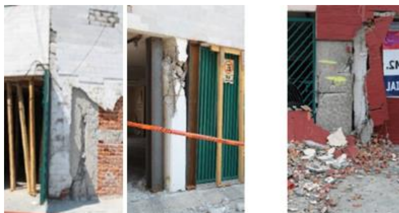
Fig. 6 - Danos em pilares associados ao descrito anteriormente, observados no após-sismo no México, 2017 (adaptado de Furtado 2020)
