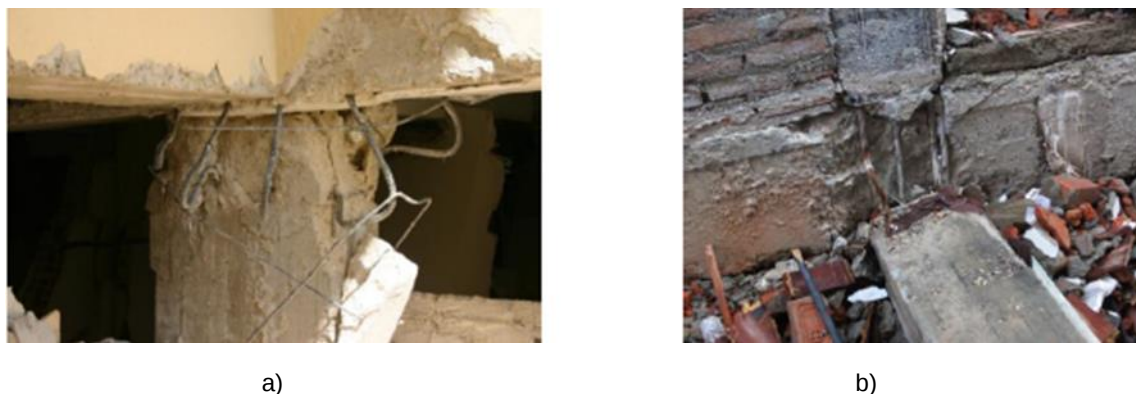
Fig. 8 - Danos associados à formação de viga forte- pilar fraco, observados no após-sismo: a) L'Aquila, Itália, 2009; b) Gorkha, Nepal, 2015 (adaptado de Vicente et al. 2012, Varum et al. 2017)
