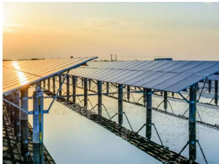
Figura 2.14 - Sistema de cobertura com módulos fotovoltaicos, que permite produzir energia, e simultaneamente fazer sombreamento a zonas de piscicultura, estabilizando a temperatura da água em níveis adequados à vida dos peixes [19]
