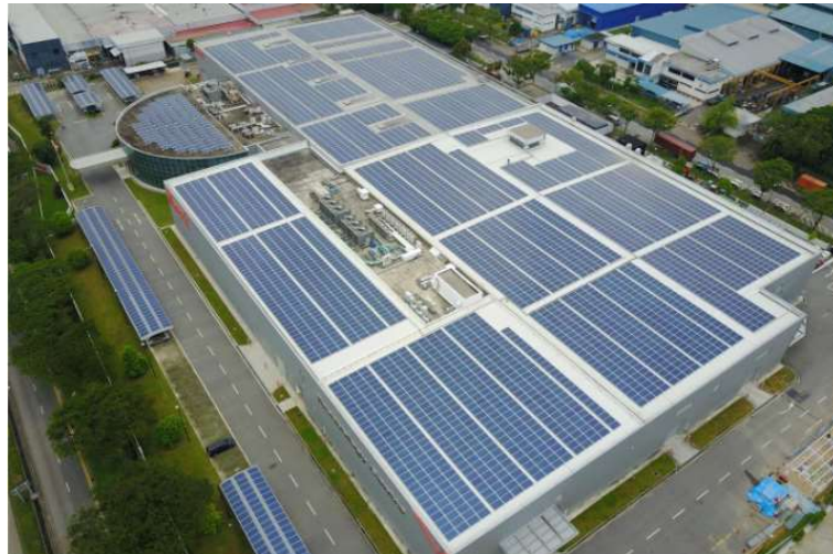
Figura 2.7 – Terraço e coberturas de parking de automóveis de empresa japonesa com painéis solares com potência de 1,6MWp [16]
