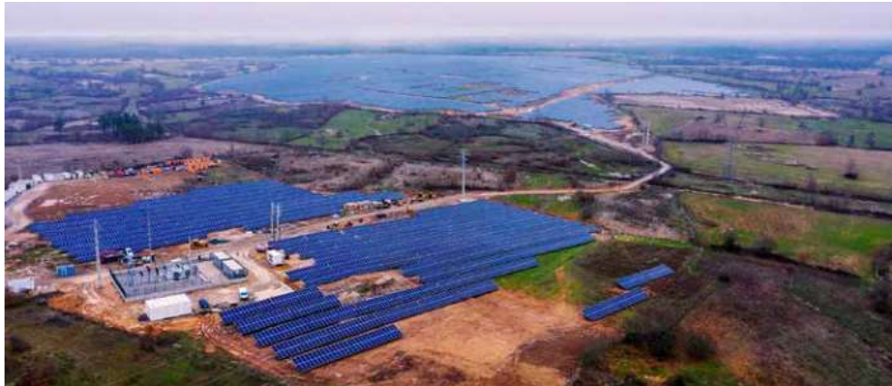
Figura 2.6 – Parque solar com potência de pico de 48,9 MW instalado em Mogadouro, Portugal [15]
