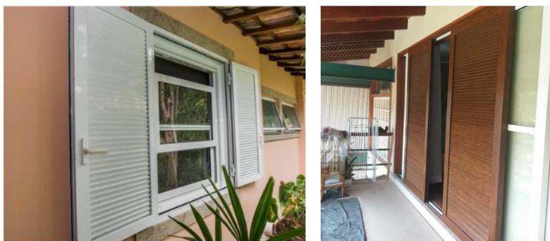
Figura 21 - Proteção com veneziana externa (SM, 2017)
