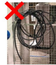
Mangueira mal arrumada
