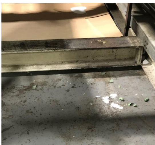
Figura 34 - Resíduos de cola no chão antes da implementação da melhoria
