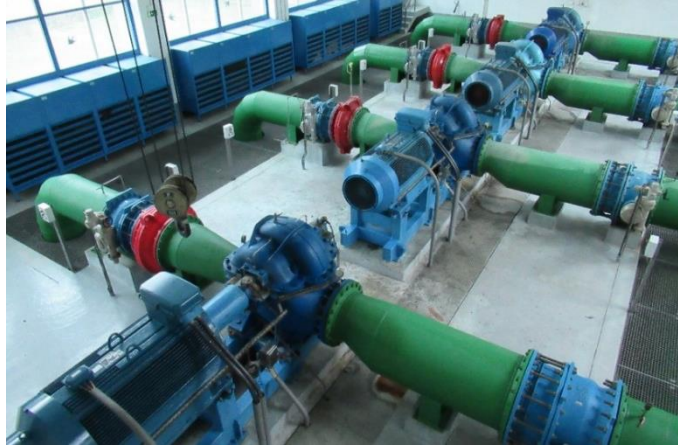
Figura 4 - Estação elevatória de Jovim da AdDP (Águas do Douro e Paiva, 2018)
