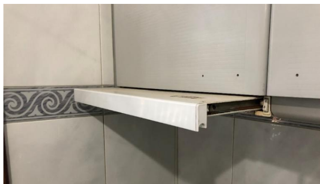
Figura 49 - Exaustor mecânico (cozinha)
