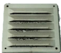
Figura 48 - Grelha de exaustão de ar no quarto de banho 1
