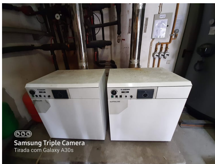
Figura 4.10 - Caldeiras na central térmica da santa casa da Misericórdia da Póvoa do Varzim
