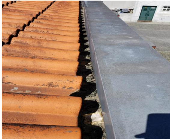
Fig. 35 Sujidade em caleira
