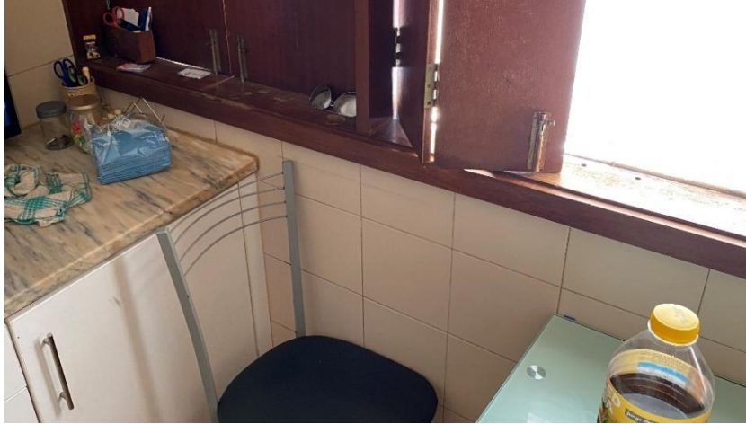
Fig. 22 Revestimento cerâmico em parede de cozinha
