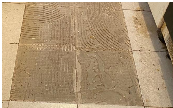
Fig. 31 Destacamento de revestimento chão
