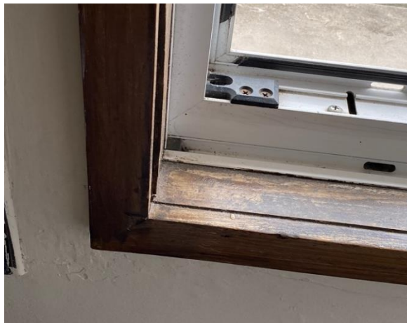
Fig. 34 Madeira empenada em apainelado de janela
