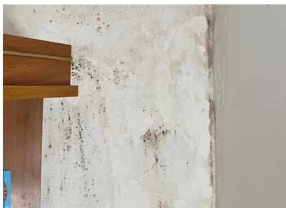
Fig. 29 Manchas e empolamento de revestimento
