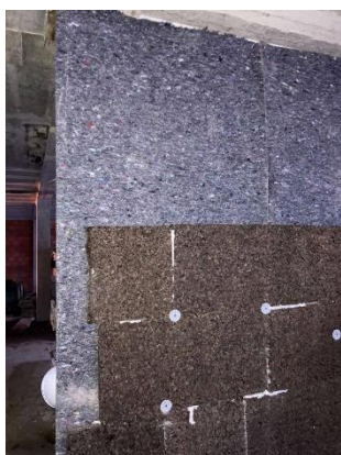
Fig. 3.13 - Isolamento Termo acústico
