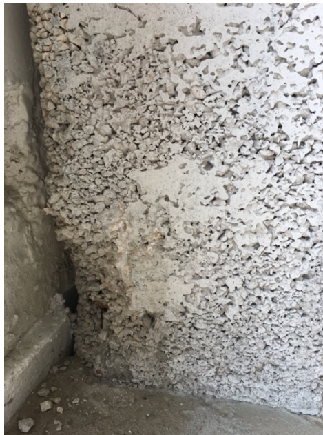
Figura 2.4 - Segregação do betão
