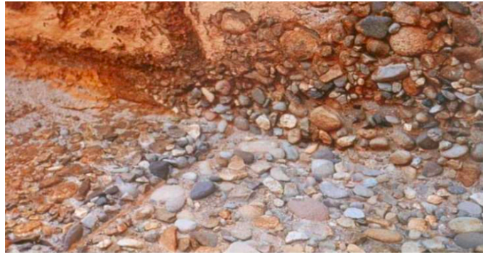
Figura 2.3 - Desagregação do betão [1]
