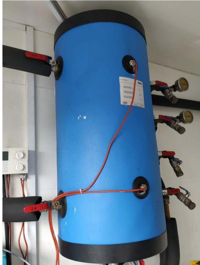
Figura 3.6 - Tanque de armazenamento térmico, com 50 l de capacidade.
