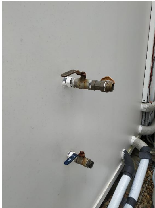
Figura 4.12 - Válvulas de entrada e saída de água, proveniente da rede pública ou do reservatório existente na FEUP, do condensador.
