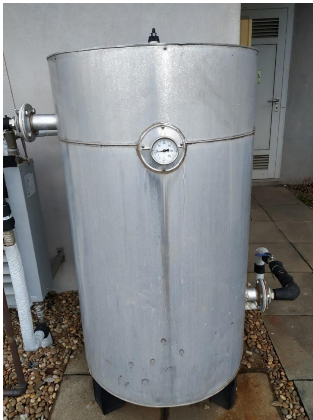
Figura 3.7 - Tanque de armazenamento térmico, com 400 l de capacidade.
