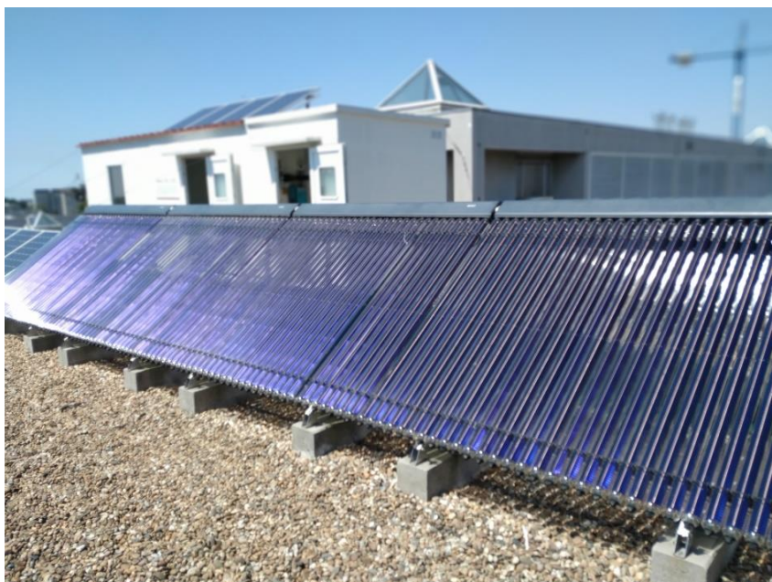
Figura 3.4 - Coletores solares térmicos de tubos de vácuo BAXI-AR-30 da instalação.
