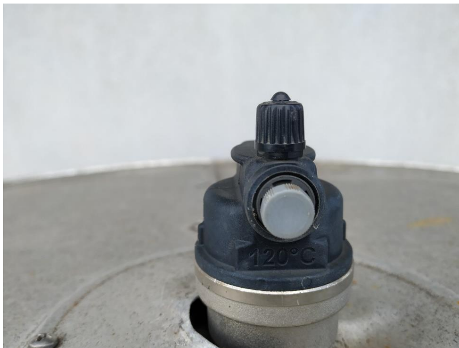
Figura 3.8 - Purgador de ar, localizado no topo do tanque de armazenamento térmico de 400 l.
