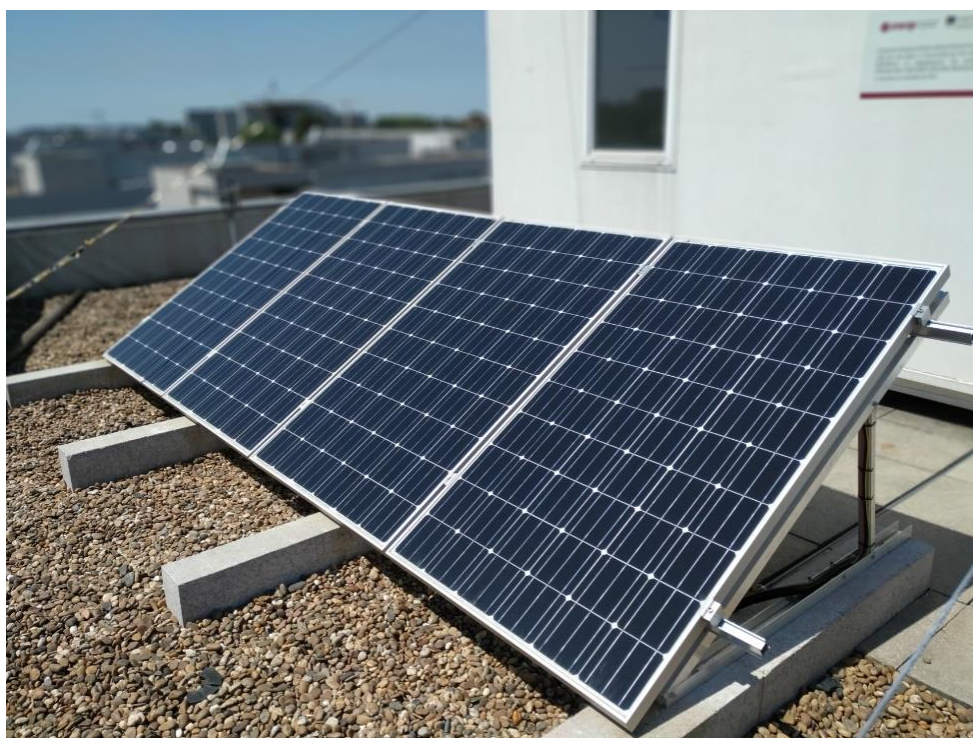
Figura 3.12 - Quatro módulos fotovoltaicos da instalação, localizados no terraço do edifício L, dispostos em série.
