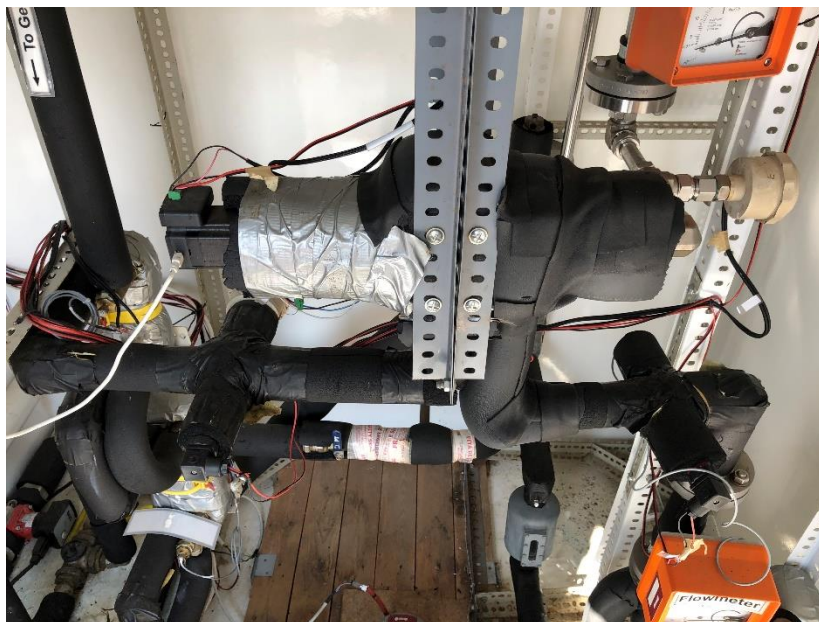
Figura 3.10 - Ejetor, revestido com isolamento, montado no ciclo frigorífico.
