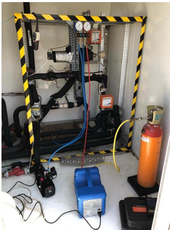
Figura 4.16 – Conexão dos tubos para carregamento de isobutano no circuito.
