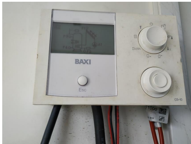
Figura 3.14 – Central de controlo existente na sala das máquinas.
