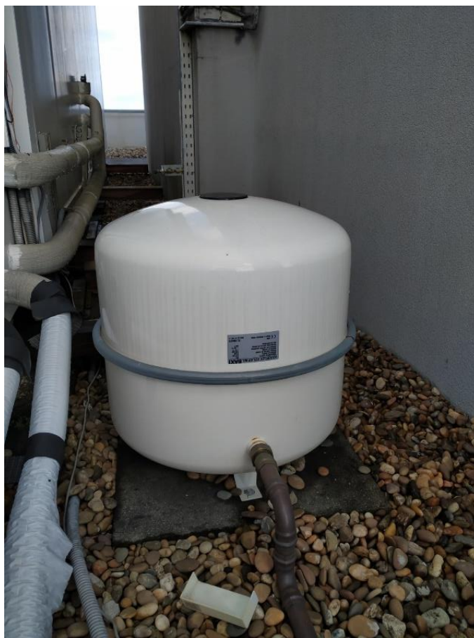
Figura 3.9 - Vaso de expansão, localizado à entrada do tanque de armazenamento térmico de 400 l.
