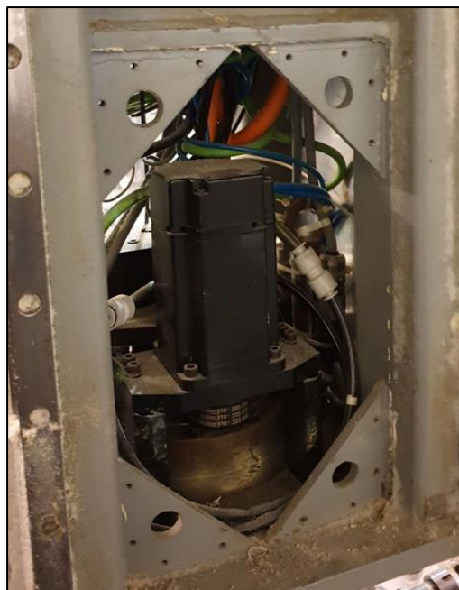
Figura 3.38 - Cabeçote do equipamento CNC com acessibilidade ao corpo estrutural do componente.
