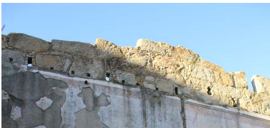
Figura 59 / Tomás F. Ceitlin Pormenor das aberturas na porção superior da parede de meiação, 2019
