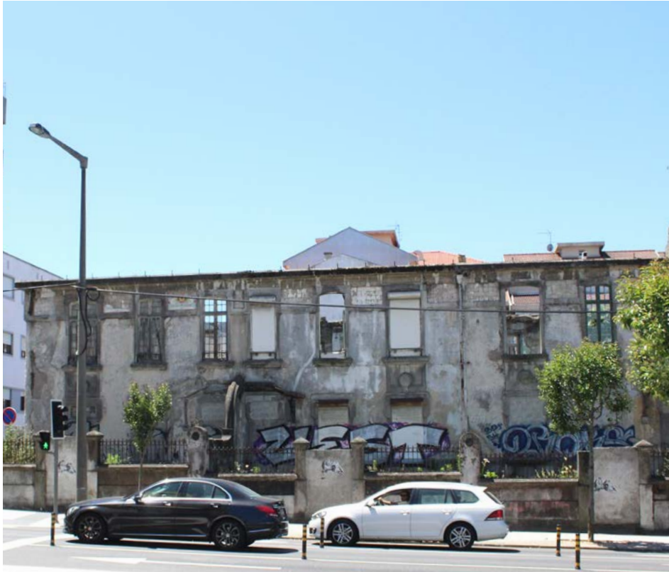
Figura 22 / Tomás F. Ceitlin Fachada do conjunto de Casas Burguesas na Rua de 5 de Outubro, evidenciando as primeiras duas casas do conjunto e uma porção da terceira da casa, 2019
