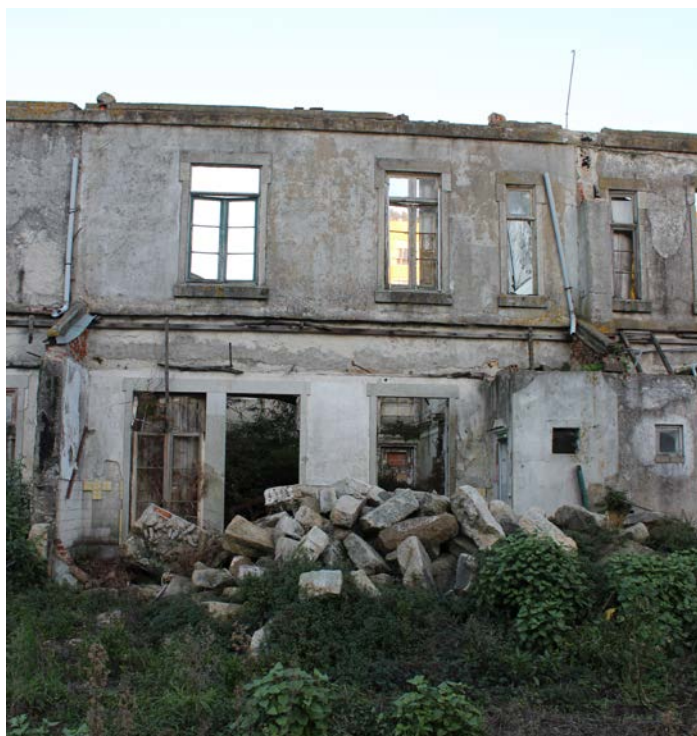
Figura 29 / Tomás F. Ceitlin Pormenor do alçado posterior, evidenciando uma unidade habitacional, bem como o anexo para o quarto de banho, 2019
