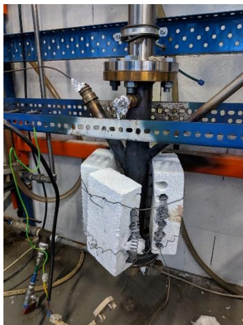
Figura 3.5 – Reator de gasificação sem manta térmica.
