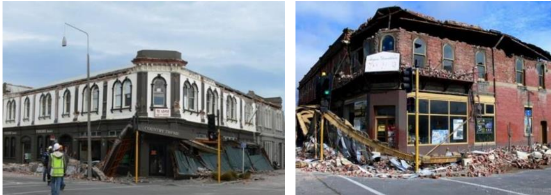
Figura 1.3 – Queda de platibandas na cidade de Darfield (www.wikipedia.com, 2020)
