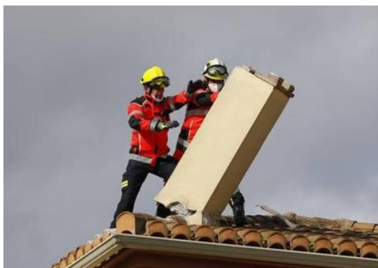
Figura 1.8 – Derrube de chaminé danificada ( www.surinenglish.com , 2021)
