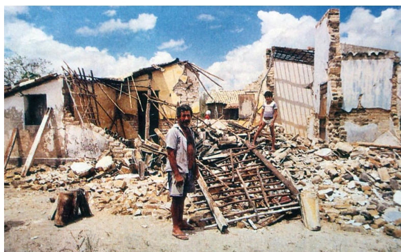
Figura 2.29. Desabamento de casa na cidade de João Câmara –RN [5]
