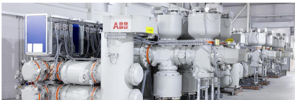
Figura 2.2: Subestação GIS Ardnacrusha na Irlanda [2]
