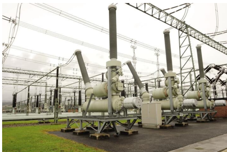
Figura 2.4: Subestação de isolamento híbrido [4]
