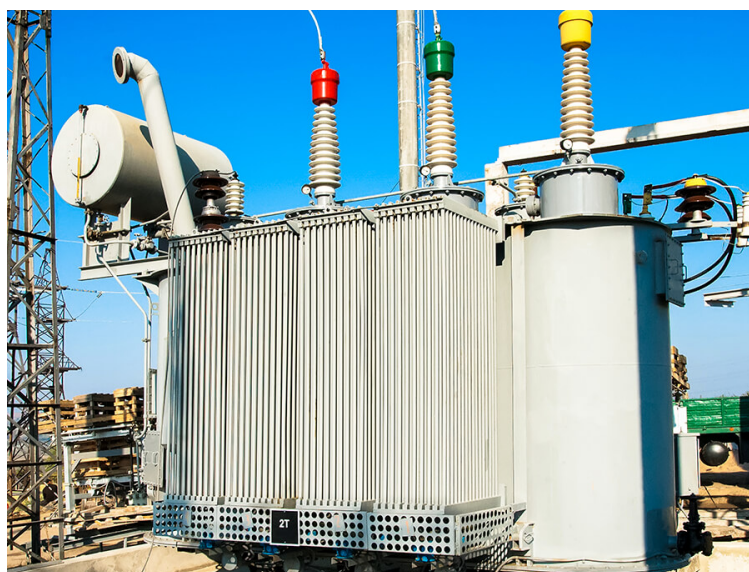
Figura 2.6: Transformador de Potência [6]
