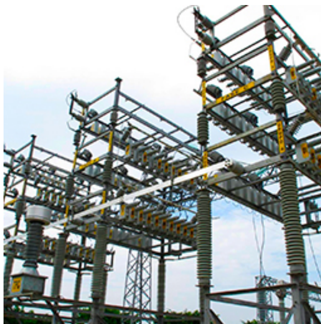
Figura 2.11: Banco de Condensadores [11]
