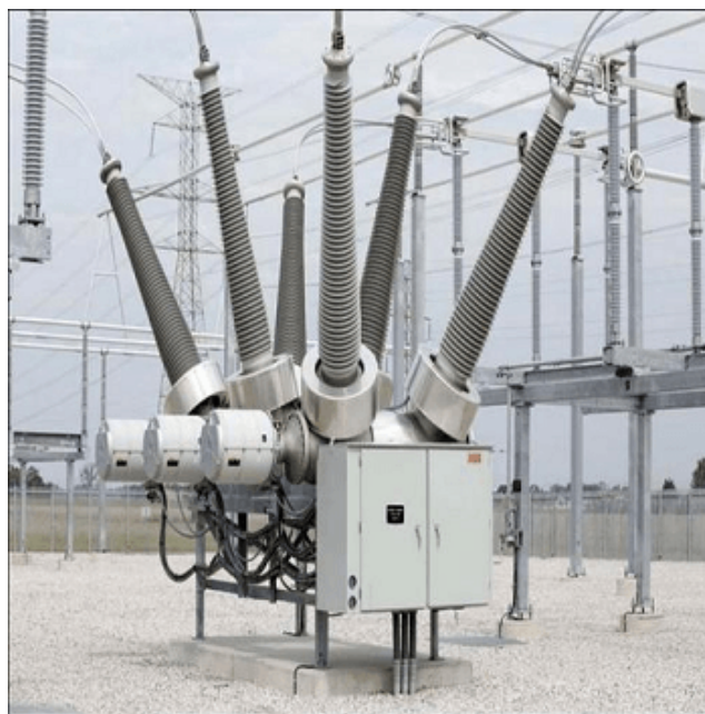
Figura 2.8: Disjuntor numa subestação [8]
