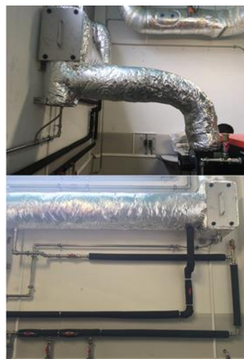
Figura 3.3 - Fotografia do economizador.
