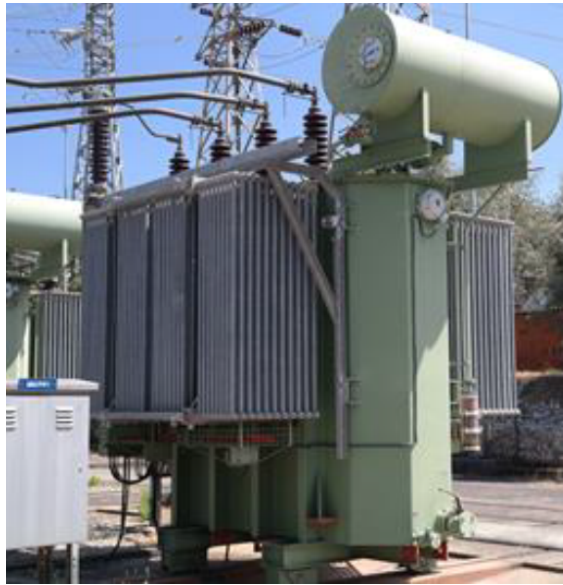
Figura 2.5: Transformador de Potência [3]
