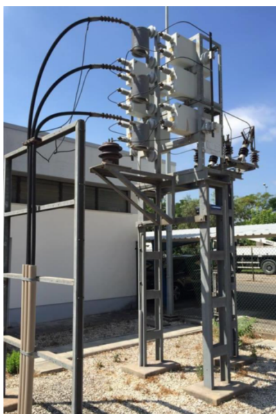
Figura 2.11: Banco de condensadores [3]
