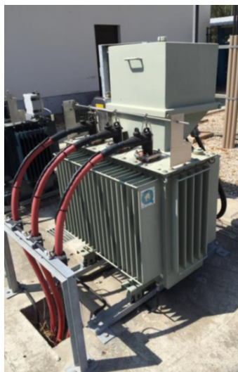
Figura 2.13: Transformador de Serviços Auxiliares [3]
