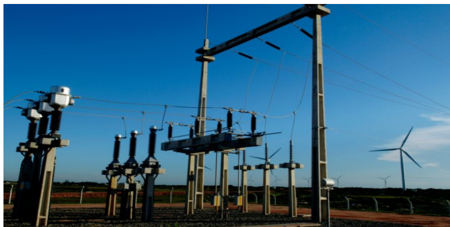
Figura 2.4: Exemplo de Subestação de parque eólico. Fonte: Portal IG
