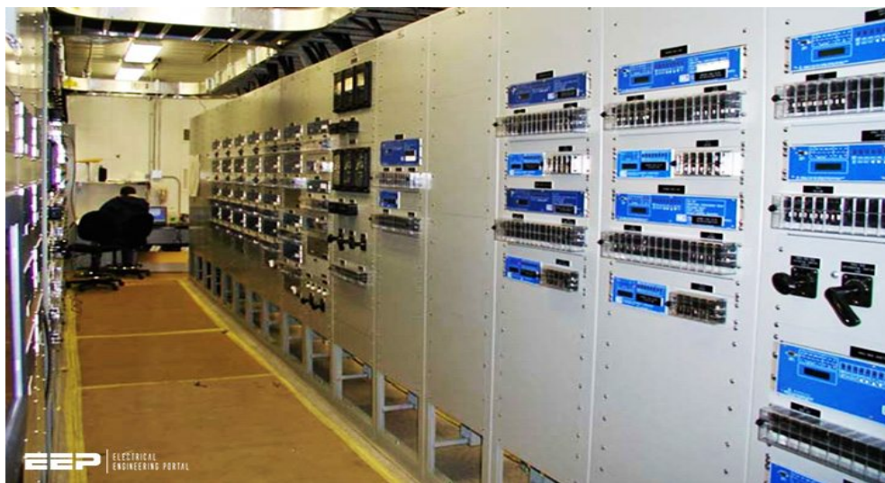
Figura 2.5: Edifício de comando com celas modulares. Fonte: EEP
