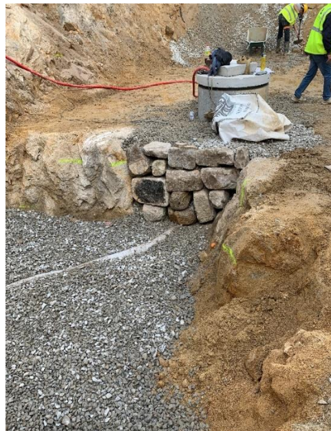
Fig. 3.21 – Poço de Bombagem
