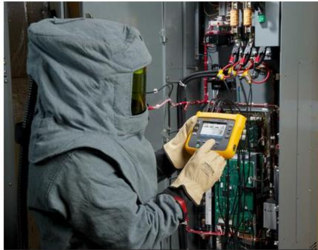
Figura 8 – Analisador energético com pinças amperimétricas ligadas a um quadro elétrico (Fonte: www.fluke.com )
