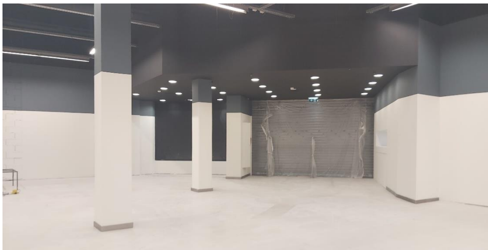
Figura 42 - Fotografia elucidativa da não conformidade na pintura das paredes.
