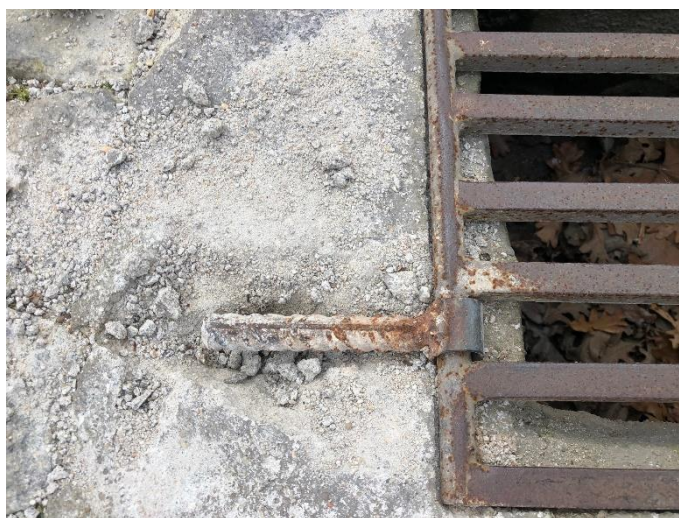
Figura 92 - Fotografia do sumidouro não cravado no pavimento.
