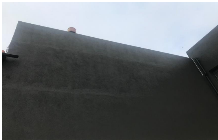
Figura 60 - Fotografia da não conformidade verificada devido à má aplicação do capoto.
