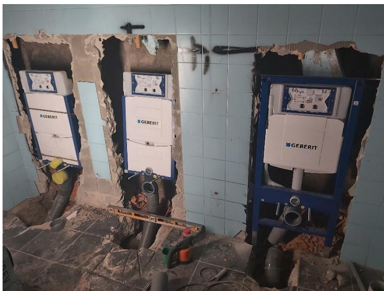
Figura 37 - Fotografia referente às aberturas para os depósitos e esgotos das instalações sanitárias.
