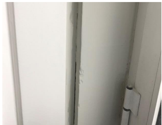
Figura 77 - Fotografia da falta de qualidade das pinturas.
