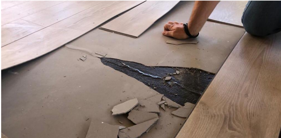
Figura 47 - Fotografia em pormenor da lomba causada pelo levantamento do pavimento devido às juntas de retração.
