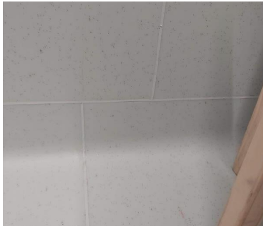
Figura 120 - Fotografia das juntas no pavimento e parede.
