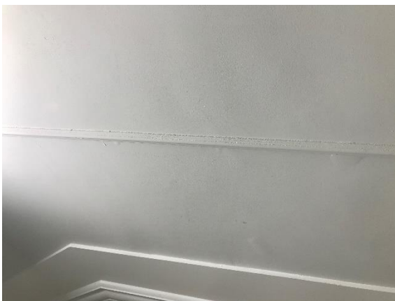
Figura 78 - Fotografia da falta de qualidade das pinturas.
