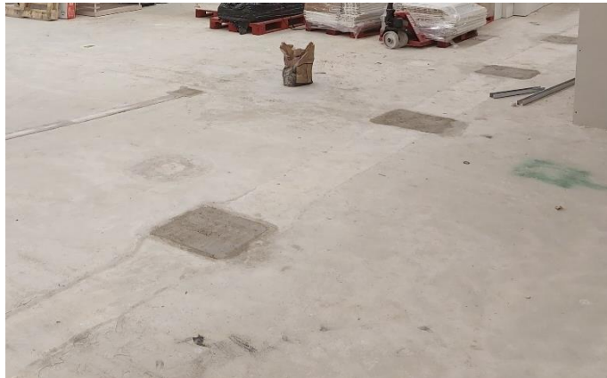
Figura 63 - Fotografia descritiva do abatimento do pavimento nas caixas.
