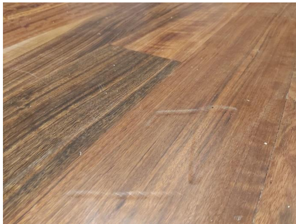
Figura 95 - Fotografia do pavimento marcado devido à falta de proteção.
