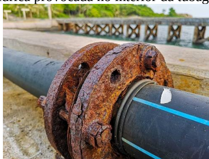
Figura 3- Corrosão no Material de distribuição de água. Fonte: Allied Corrosion Industries Inc.
