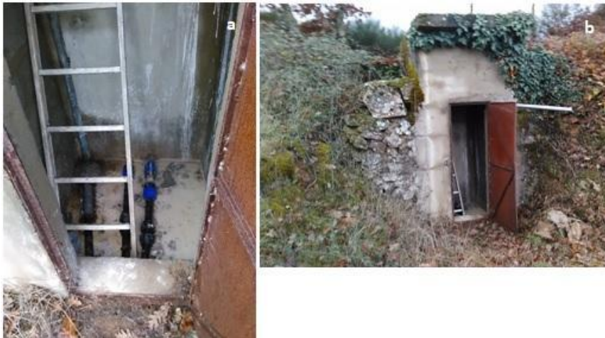
Figura 8:Estação de Tratamento de água a) Interior e b) exterior, na freguesia de Moreiras, em 15/12/2017
