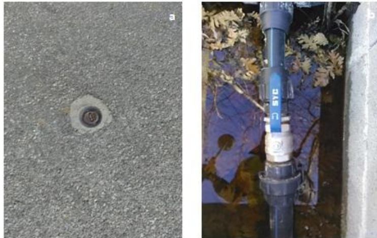
Figura 19: a) Válvula de Seccionamento do tipo Cunha; b) Válvula de Seccionamento do tipo Esfera, nas freguesias de Vilas Boas, em 05/12/2017
