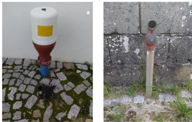
Figura 16: a) Marco de Incêndio; b) Boca de Incêndio, nas freguesias de Tronco e Redondelo, em 29/01/2018
