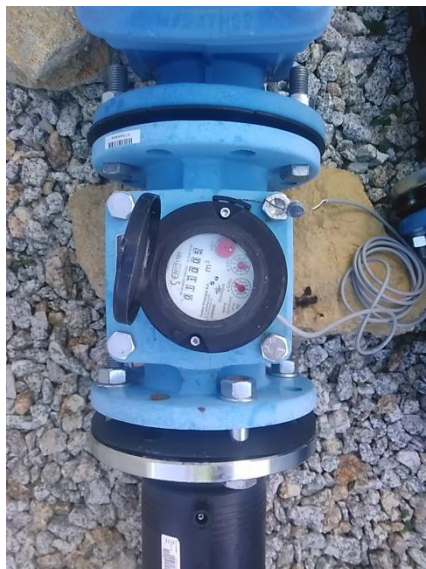
Figura 21: Medidor de Caudal, na freguesia de Planalto de Monforte, em 11/01/2019
