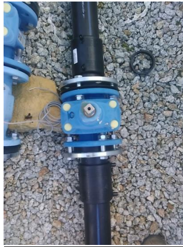
Figura 17: Válvula de Descarga, na freguesia de Planalto de Monforte, em 11/01/2019
