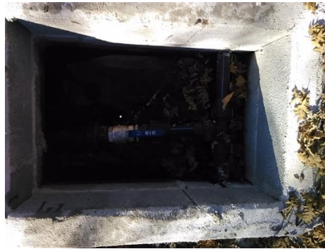
Figura 9: Caixa de Manobras, na freguesia de Planalto de Monforte, em 03/01/2019
