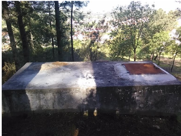
Figura 13: Câmara Perda de Carga, na freguesia de Vila Verde da Raia, em 30/04/2019
