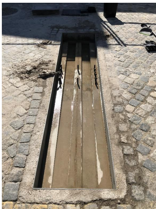
Figura 30 - Interior do suporte do protótipo da Pavnext após um ano e quatro meses de instalado
