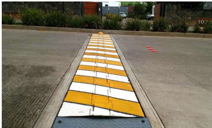
Figura 14- Solução final da instalação do sistema Tope Inteligente- Inteligencia Vial
