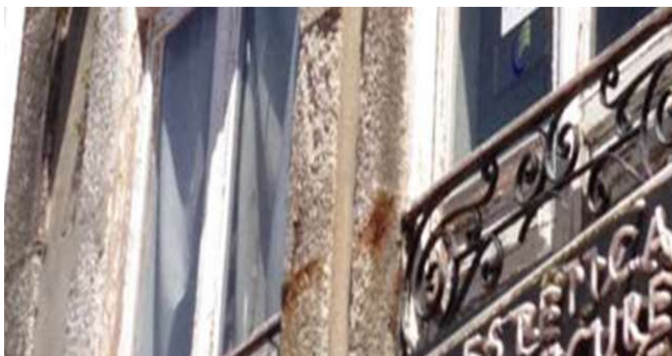
Figura 5.11 – Sinais de oxidação da pedra provocada pela degradação da guarda da varanda.
