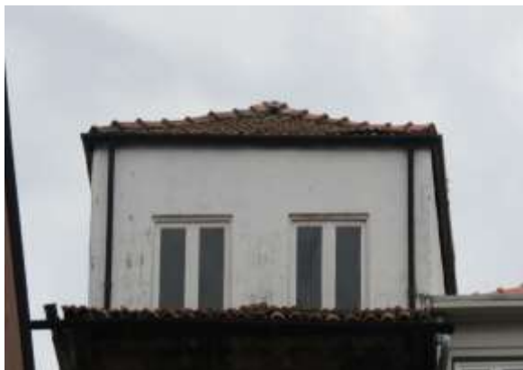
Figura 5.5 – Pintura degradada em fachada de piso provavelmente acrescentado ao original.
