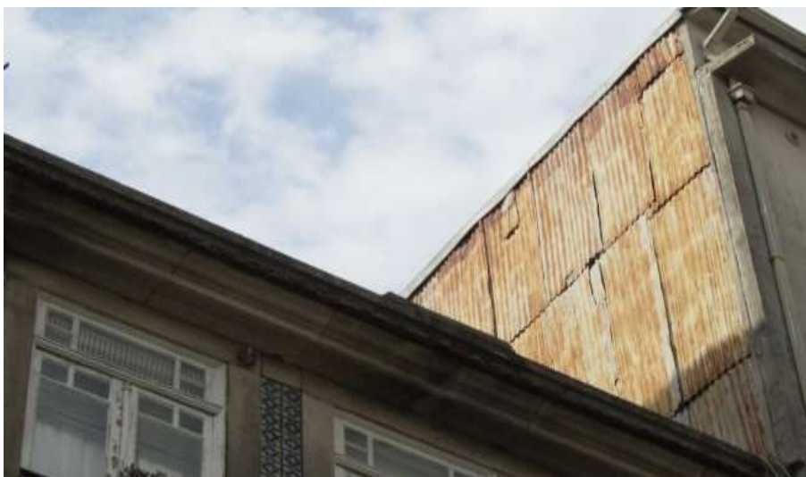
Figura 5.10 – Sinais de oxidação do revestimento em chapa de uma empena.
