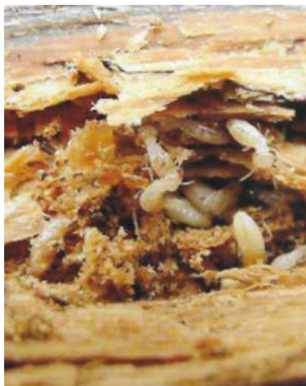
Figura 5.3. – Degradação causada por térmitas (Retirado de[2]).
