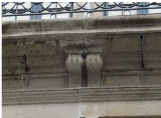
Figura 5.8 – Sinais de eflorescência de cantarias em pedra.
