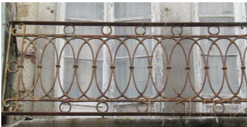
Figura 5.9 – Sinais de oxidação de gradeamento de varanda em ferro fundido.
