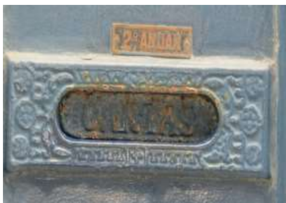
Figura 3.5 – Pormenor – Identificação de caixa do correio (2).
