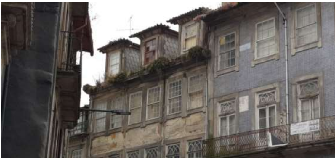
Figura 5.2 – Sinais de degradação de alguns edifícios tipo Casa Burguesa da cidade do Porto.
