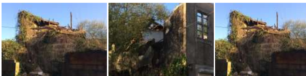
Figura 3.2 – Registo fotográfico da envolvente de um edifício em elevado estado de degradação – ruínas.
