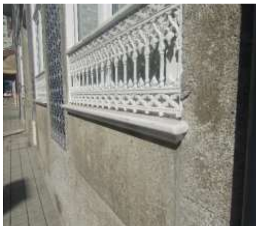
Figura 4.15 – Visualização da soleira em madeira da janela.
