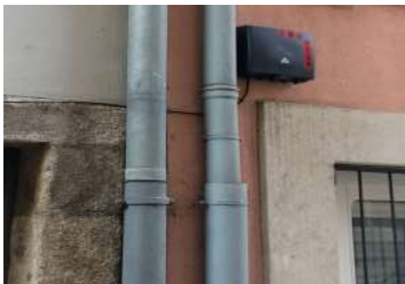
Figura 4.2 – Pormenor dos tubos de queda.
