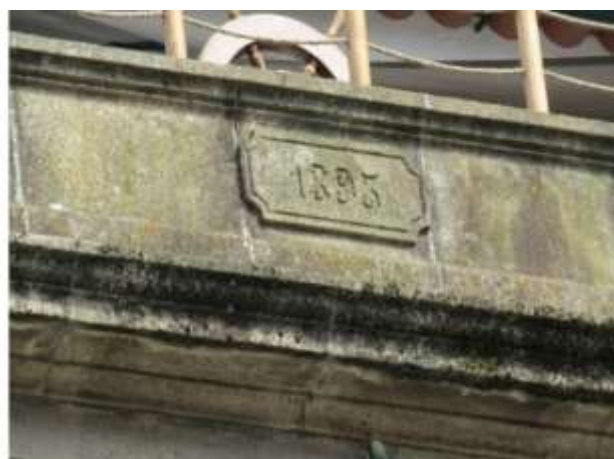
Figura 5.7 – Sinais de degradação da pedra das fachadas.
