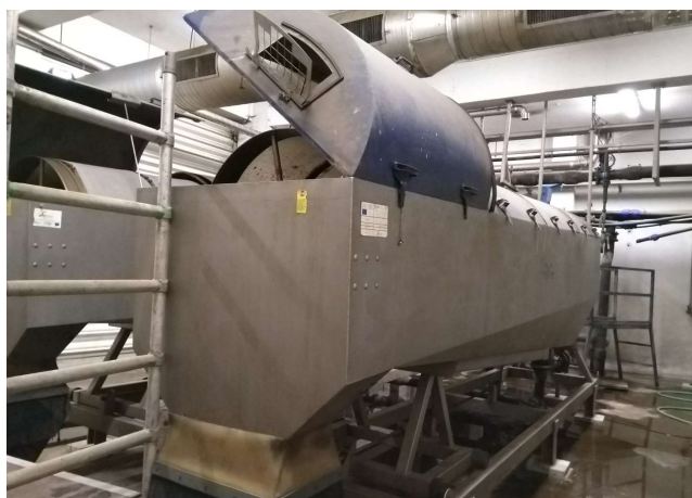
Figura 20 - Sala dos Espessadores
