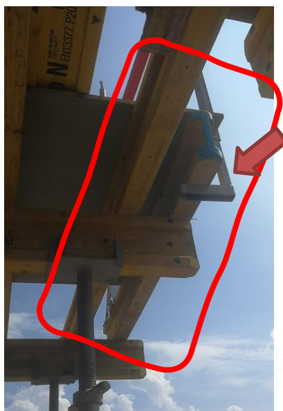
Figura 74 – Montagem incorreta do sistema de guarda-corpos
