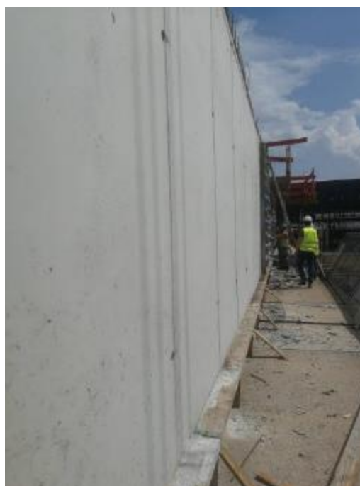
Figura 37 – Muro betonado e sem cofragens
