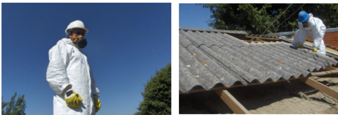
Figura 4.3 - Fotos de trabalhadores na remoção de fibrocimento sem o capuz do fato de proteção descartável.
