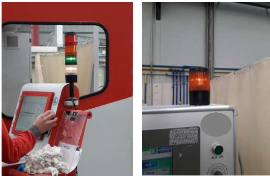
Figura 58 - Sistemas visuais de alerta do modo de funcionamento de equipamentos CNC da TORRE.
