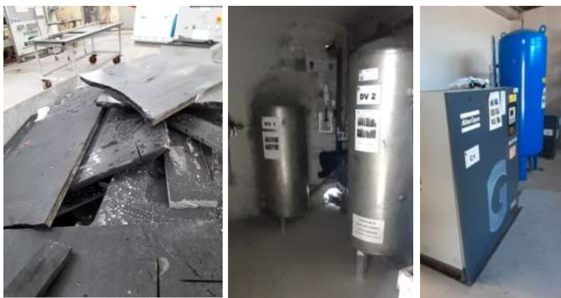
Figura 42 – Contentor com resíduos sólidos (esquerda), unidade de tratamento e reciclagem de água (centro) e central de produção de ar comprimido (direita) da TORRE.
