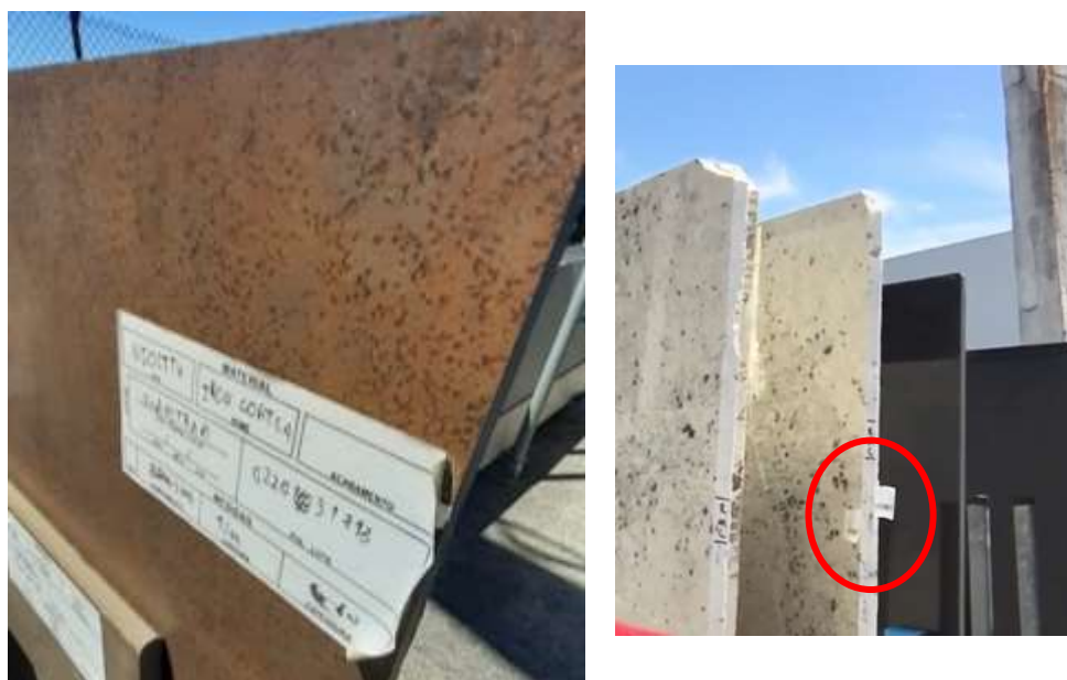
Figura 80 - Etiquetas de chapas na TORRE em processo de descolagem.
