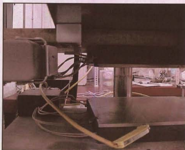
Figura 3.3.3 – Prato aquecido com a fonte de alimentação. Visualização dos pratos com os dispositivos de controlo e caixas de alimentação das resistências eléctricas.
