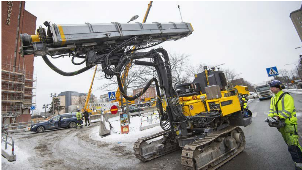
Figura 30 – Exemplo de aplicação de equipamento de perfuração do tipo top-hammer numa obra publica delicada (Epiroc, 2019).
