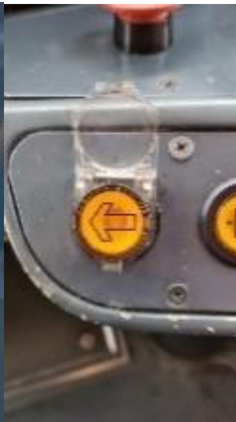
Figura 35: P6-1 Autorização de abertura de porta do lado esquerdo
