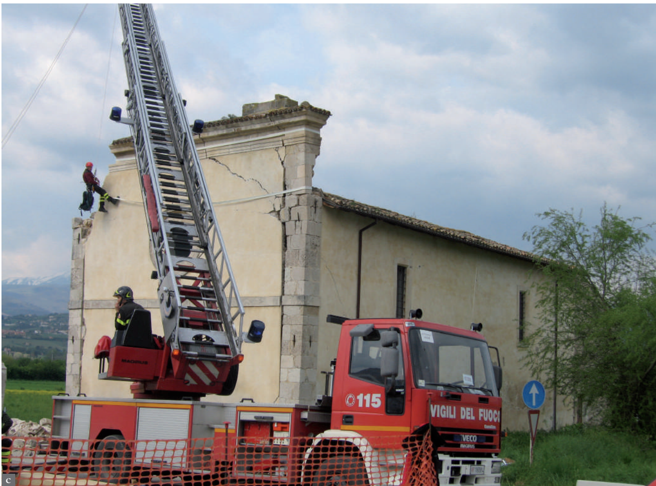
Figuras 7 a, b y c. Intervenções de estabilização de emergência em património cultural imóvel.
