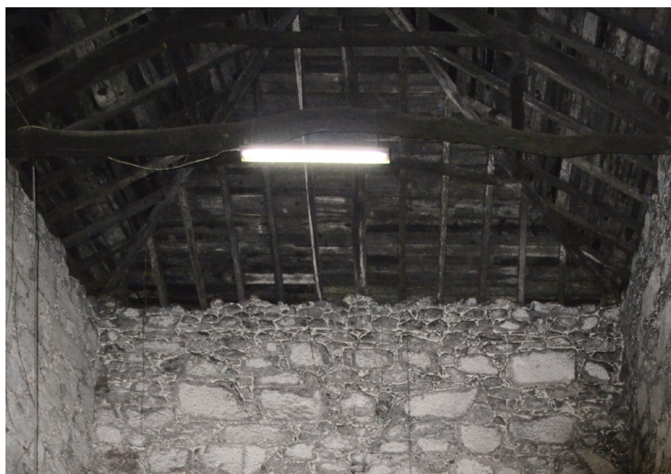
Fig.95 Apodrecimento das madeiras da estrutura do telhado, presença de humidade e de colonização biológica, armazém G
