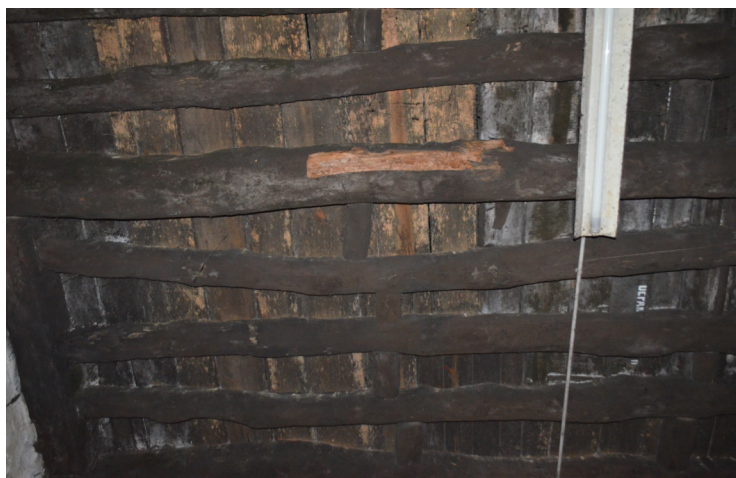
Fig.96 Apodrecimento do sobrado (vigamento e tábuas de soalho de madeira), manchas de humidade, ataque de fungos e colonização biológica, armazém G
