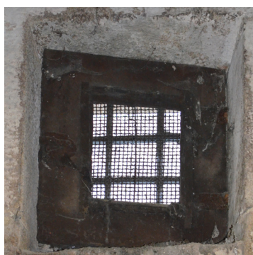
Fig.99 Apodrecimento das portadas de madeiras do postigo, e oxidação das ferragens, armazém G
