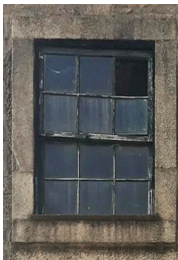
Fig.97 Apodrecimento do caixilho exterior em madeira, devido a causas atmosféricas, armazém G
