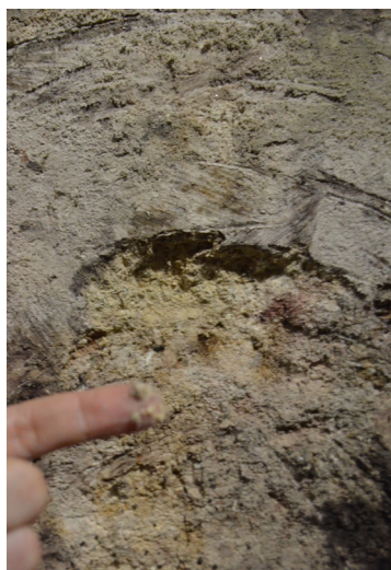
Fig.93 Colonização biológica das argamassas de revestimento por fungos e bactérias, armazém G
