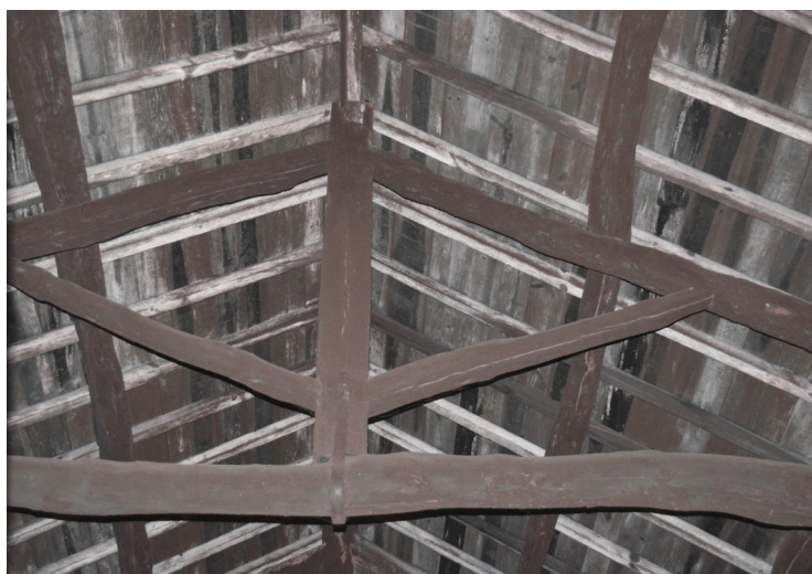
Fig.94 Apodrecimento das madeiras da estrutura do telhado, presença de humidade e de colonização biológica, armazém F
