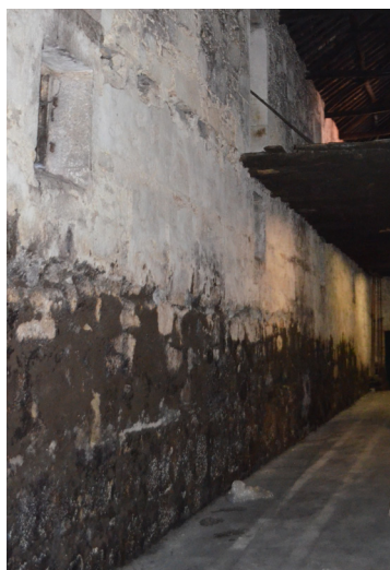
Fig.91 Infiltração de humidade por deficiência de conceção das caleiras, armazém F
