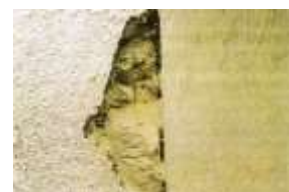
Fig. 2.41 - Perda localizada de betão
