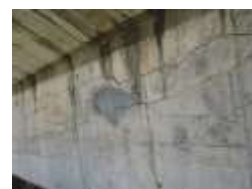
Fig. 2.39 - Fissuração devido a reação álcali-sílica [18]
