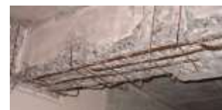
Fig. 2.40 - Viga com betão desagregado [18]
