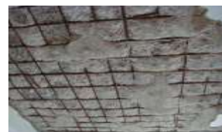
Fig. 4.15 - Desagregação em uma laje de betão armado [45]
