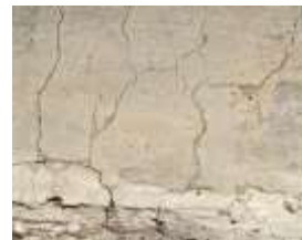
Fig. 2.24 – Fissuras devido ao aumento da temperatura [18]
