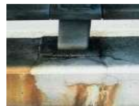
Fig. 2.37 - Manchas de ferrugem provocadas pela corrosão das armaduras [18]
