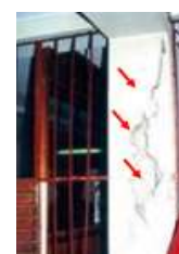
Fig. 2.34 - Fissuras provocada pela ação sísmica [18]
